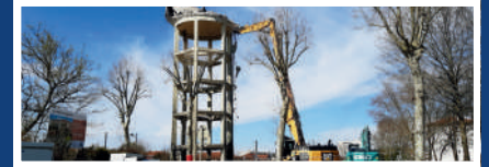
Destruction du réservoir Montrotier
